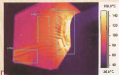
Imagem Termográfica Motor 400 CV – Falha no Retentor Dianteiro do Motor.
