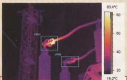
Transformador de 25MVA – com problema na conexão de Entrada do Transformador.
