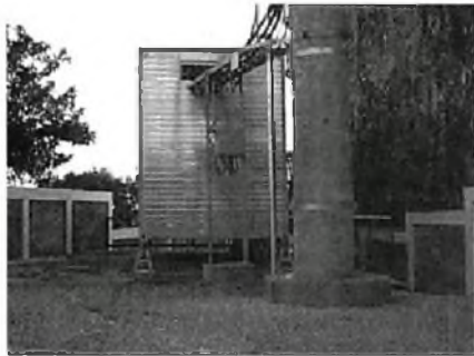
Fig. 14 - Uma ERB instalada num container.
