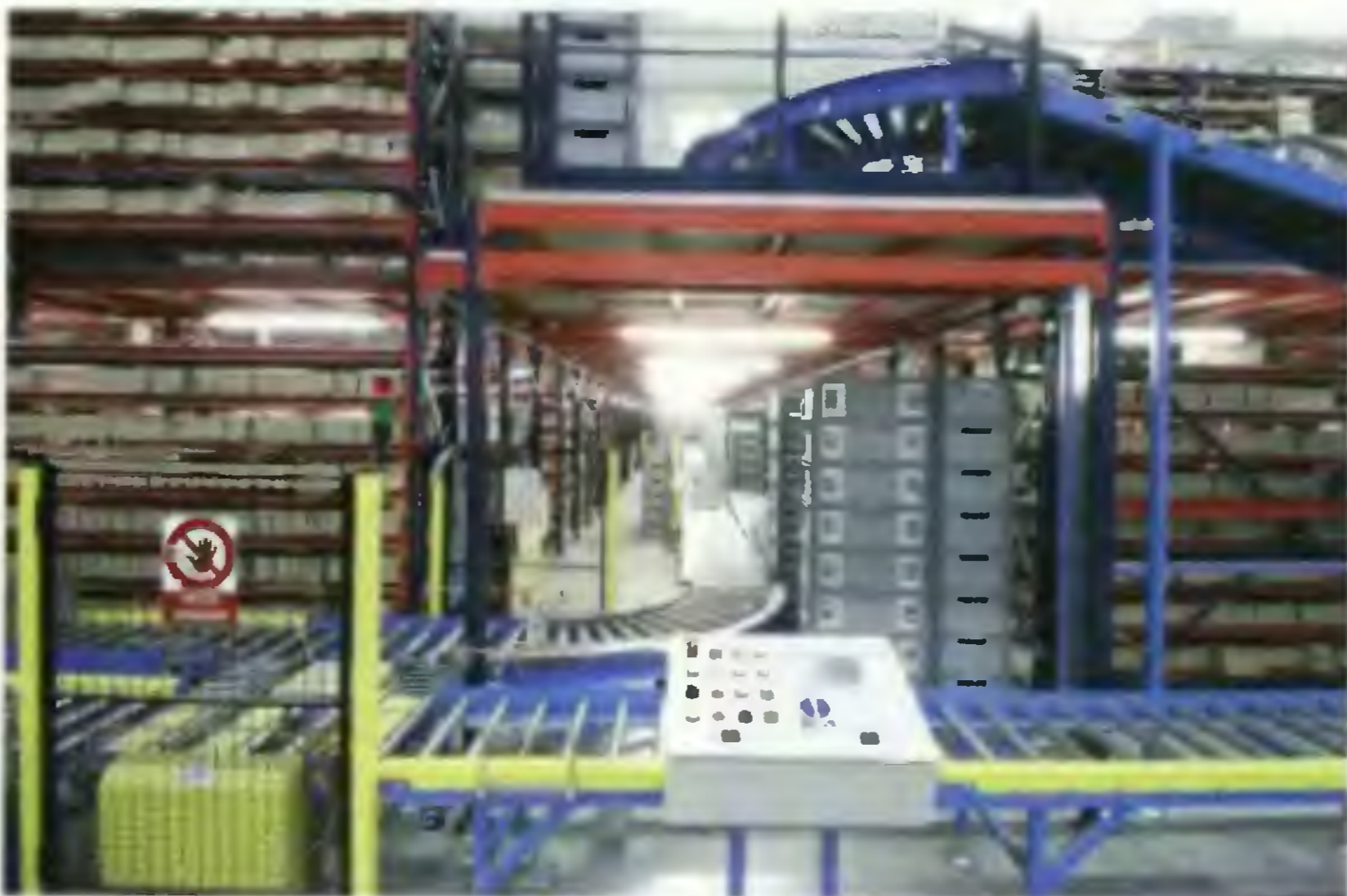
Obr. 1. Technické vybavení nového automatizovaného skladu
